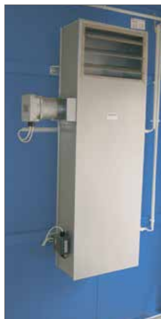
Chauffage à circulation d'air
