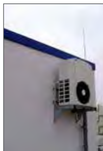
Système de climatisation
