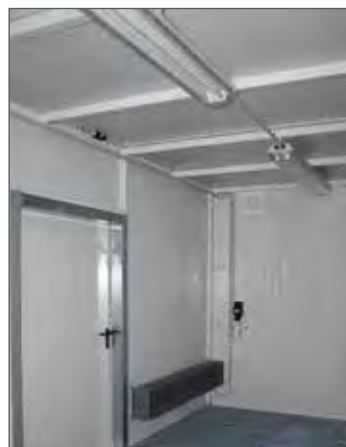
Vue intérieure avec luminaire tube long et radiateur tube à ailettes
