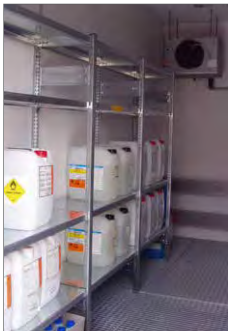
Rayonnage petits contenants et système de climatisation
