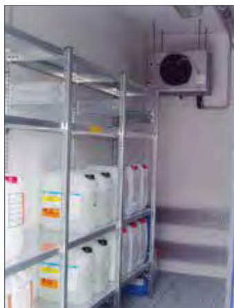
Rayonnage petits contenants et système de climatisation
