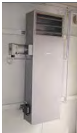
Chauffage à circulation d'air
