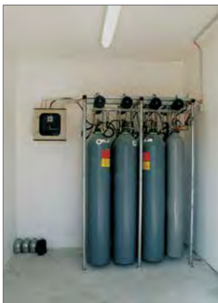
Extincteurs protégés dans une pièce technique sécurisée coupe-feu F-90
