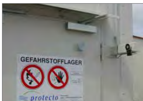
Rebord de protection pluie et système de maintien des portes avec fermeture automatique
