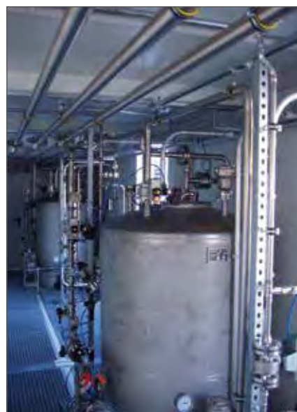
Pièce technique sécurisée avec station de dosage et mélange intégrée
