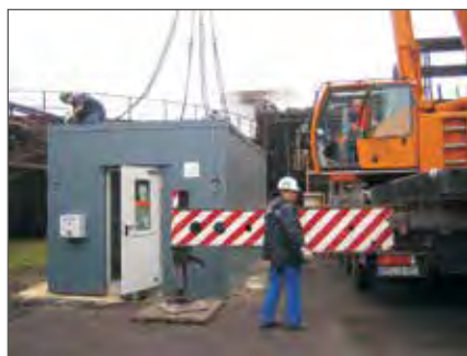
Montage d'une pièce technique sécurisée centralisée en extérieur
