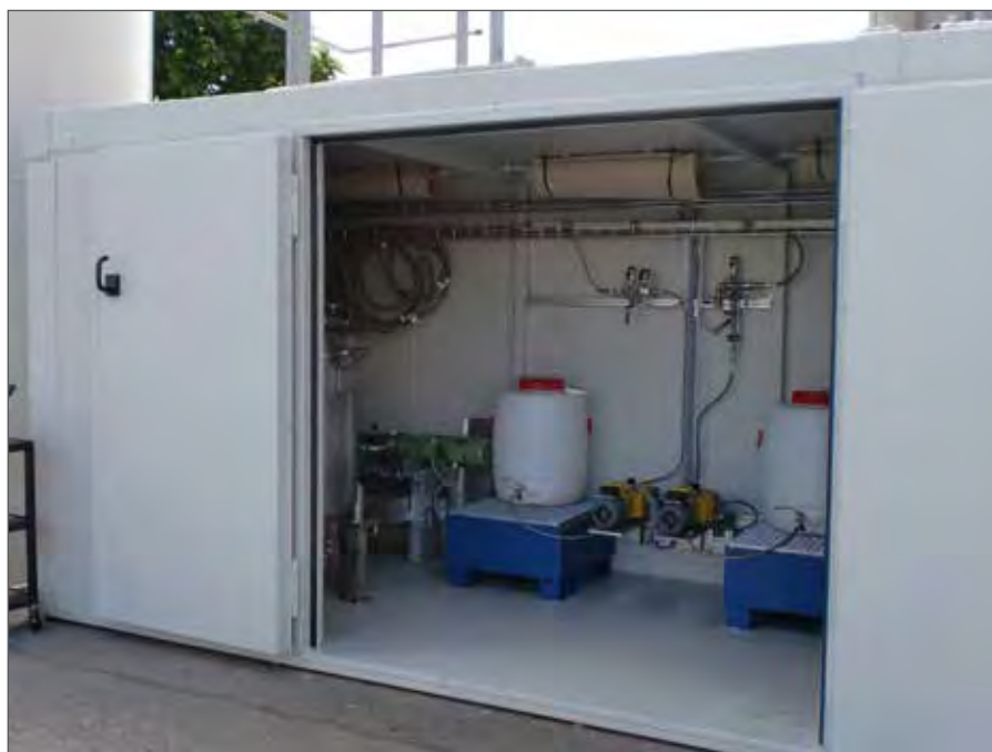
Pièce technique sécurisée coupe-feu F-90, intérieur et extérieur, pour un emplacement extérieur
