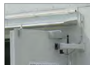
Système de fermeture des portes avec électro-aimant, fermeture automatique de portes en cas de détection de feu
