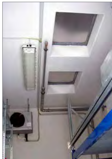
Deux clapets de décompression dans le toit d'un conteneur coupe-feu en béton dks pour le stockage de peroxide
