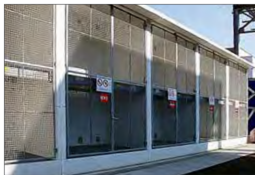
Installation de conteneurs coupe-feu à rayonnage dk 06 avec portes grillagées
