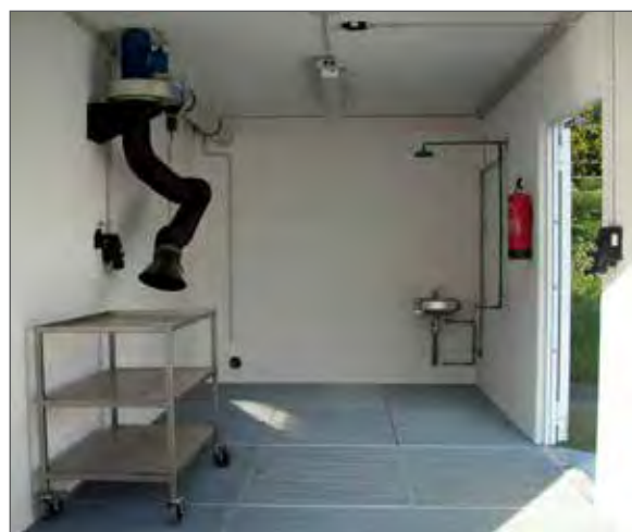
Aménagement intérieur individuel avec point d'aspiration, luminaire long, lavabo et douche de sécurité
